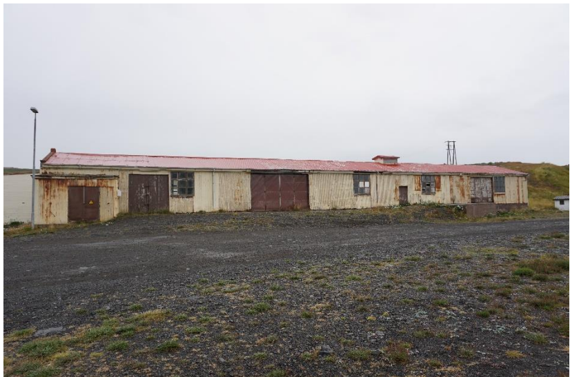
Mynd 63. Gamla sláturhúsið sumarið 2017. Það er byggt árið 1914 og heyrir því undir aldursfriðunarákvæði laga um menningarminjar. Húsinu hefur ekki verið haldið við um langt skeið og húsið liggur undir skemmdum.
